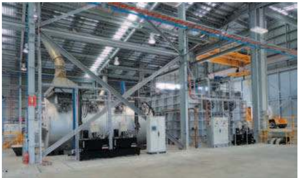
Алюминиевые подогревательные и плавильные печи 10 тонн, фото из личного архива «Midal Australia»
