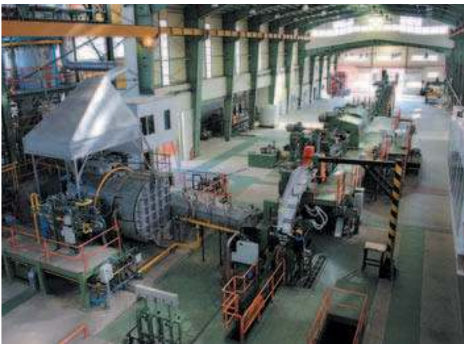
Станция очистки сточных вод от меди линия CCR 12,5 т/ч, фото из личного архива «GilRod Shomal»
